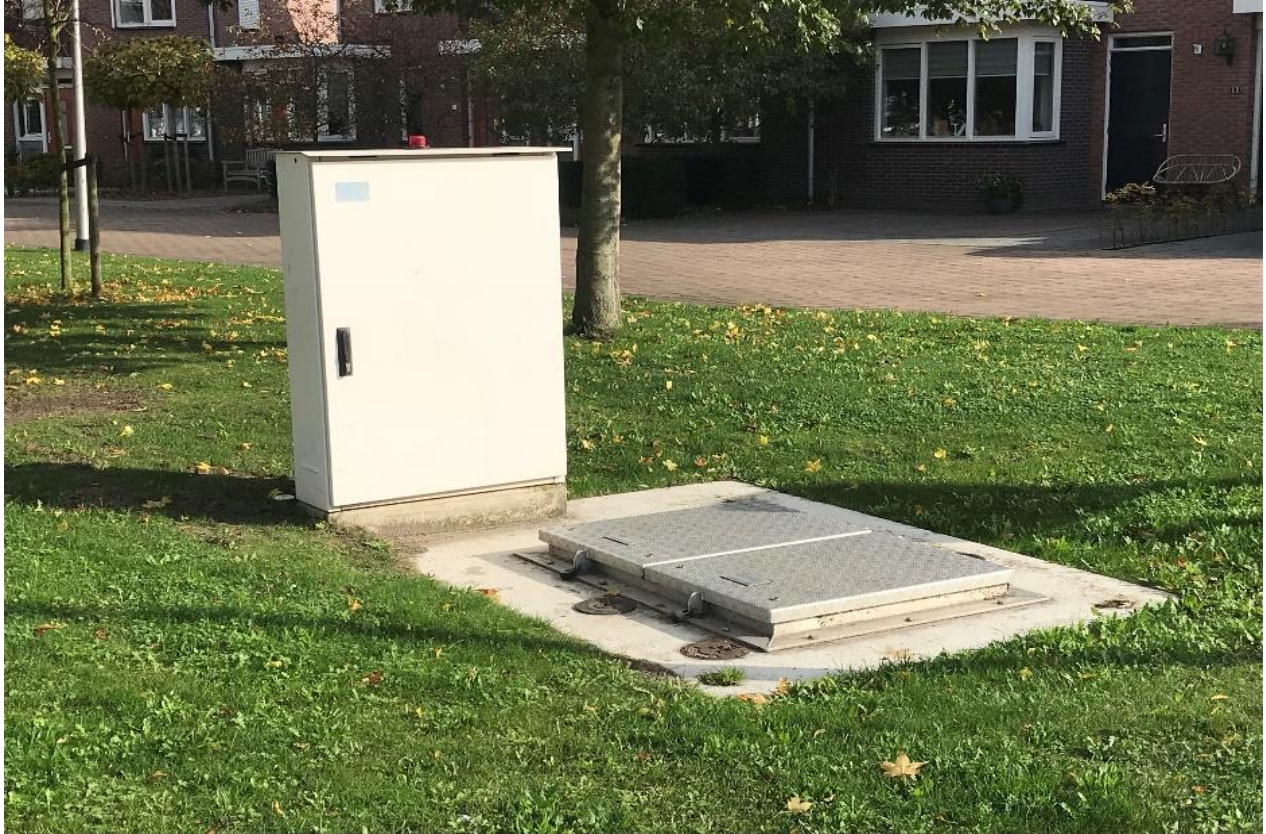
Figuur 5-4: Gemaalkast met gemaalluiken
