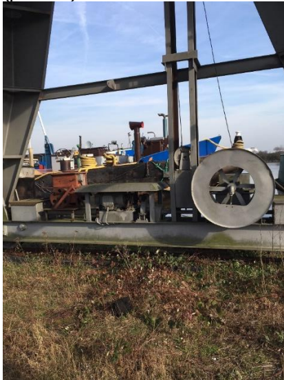
Gewicht aangedreven voedingskabelhaspel (Foto: Hens ter Kuile)
