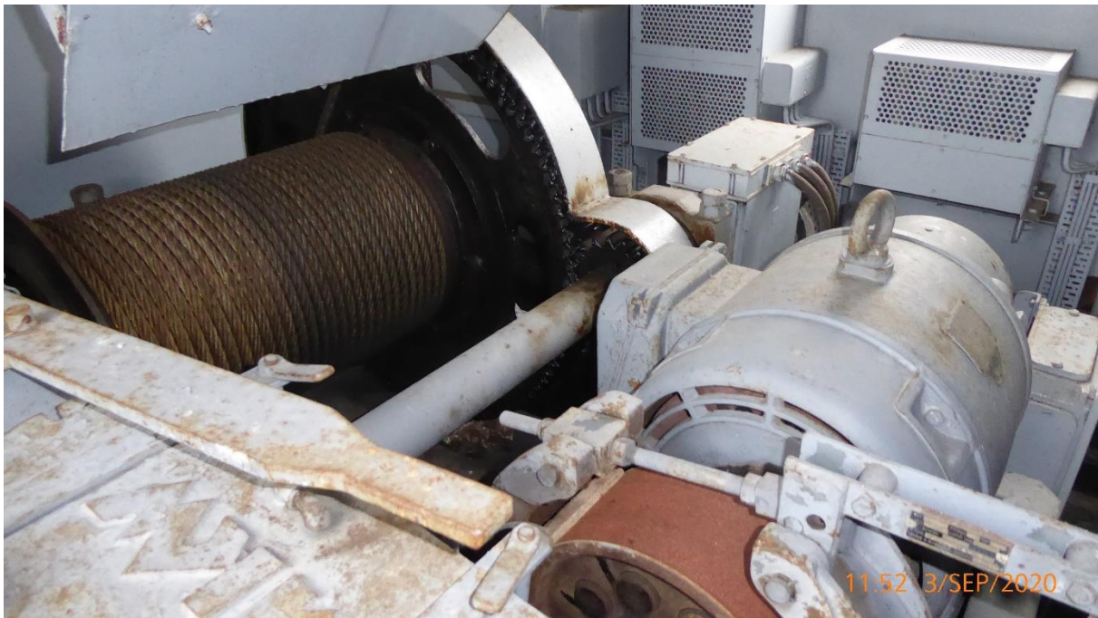
Hijswerk met motor, rem, tandwielkast, tussenas, eindschakelaar, eind trap en trommel (Foto: Gerard Jacobs)
