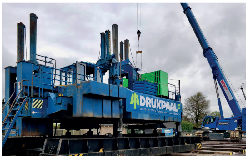
■ In de Oranjebuurt bouwt Rhiant 116 moderne sociale huurwoningen. Een groot deel van funderingspalen wordt daar in de grond gedrukt, in plaats van geslagen. Die manier van werken geeft minder hinder aan de omwonenden. Meer info over het werk vindt u op rhiant.nl .
